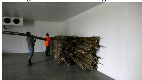
Stockage Chambre froid négatif
